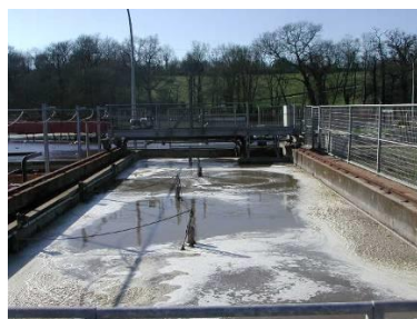
Des refus du dégraisseur-dessableur : des sables / des graisses
