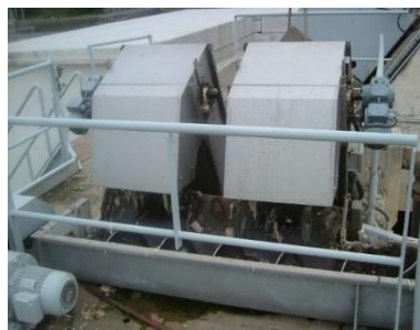
Des refus de dégrillage : Matières solides...
